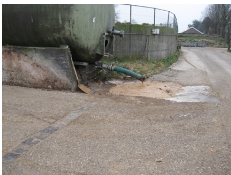
Foto: Lekkende afsluiter bij de opslag van natte bijproducten in een tank
