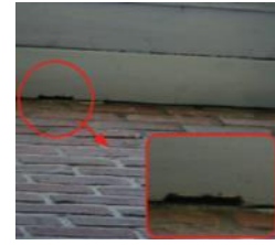
Foto 6: twee invliegopeningen, zodat vleermuizen de ruimte achter de gevelbetimmering kunnen gebruiken.
